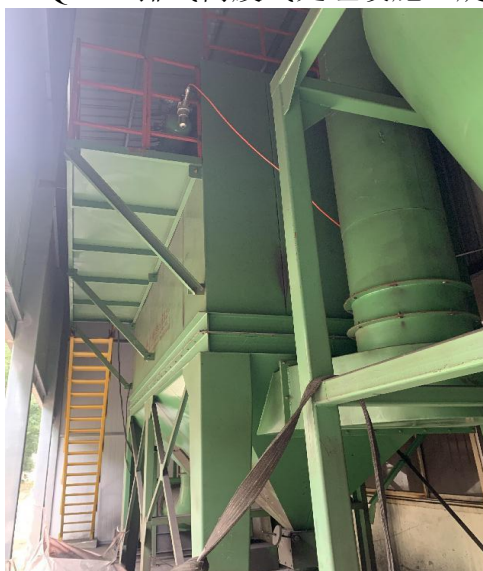
FQ-015 排气筒废气处理设施：旋风+脉冲布袋除尘
