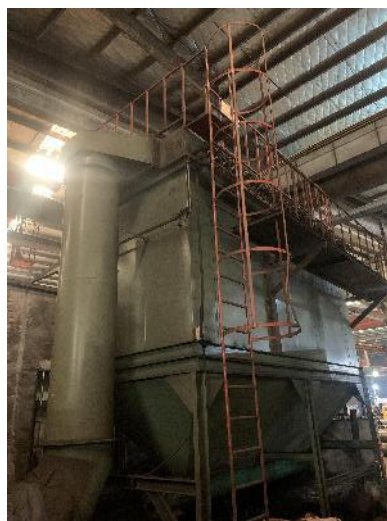
FQ-008 排气筒废气处理设施：旋风+脉冲布袋除尘
