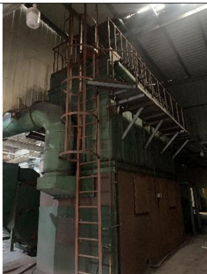
FQ-005 排气筒废气处理设施：旋风+脉冲布袋除尘
