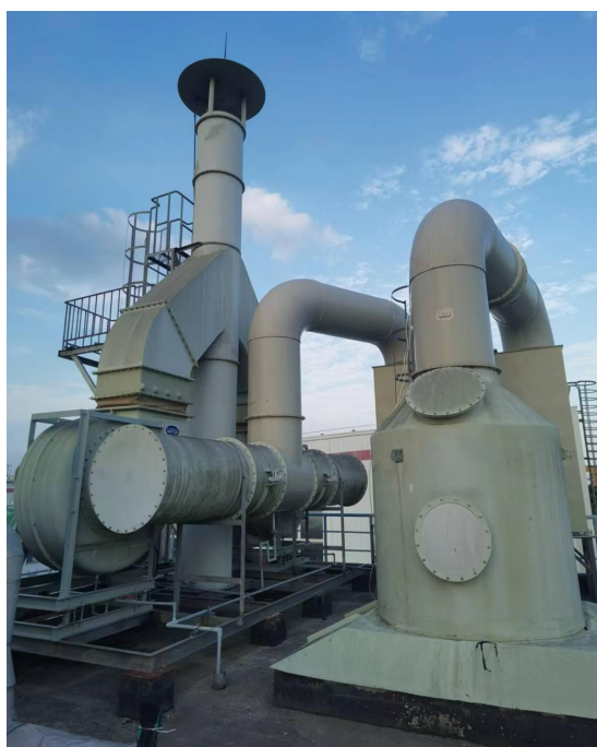
过滤网过滤+洗涤塔+过滤棉+二级活性炭装置 (DA001)
