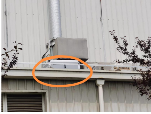
取样废气活性炭过滤器装置
