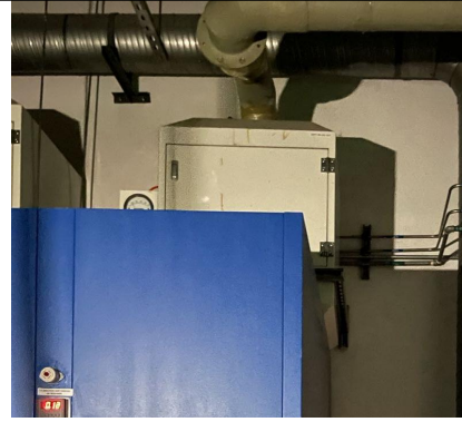
含氮磷物料分装废气高效过滤器装置
