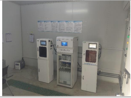
污水排放口在线监控
