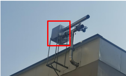
气体精密过滤装置（单壁碳车间）
