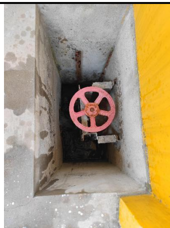
生产废水排口切断阀照片
