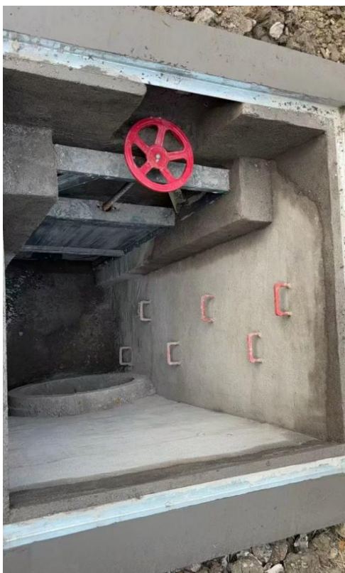
微纳园园区雨水切断阀
