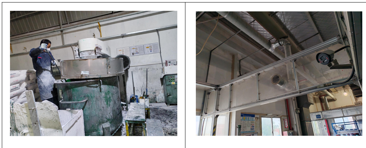
图 6.1-2 拆包、投料、搅拌集气罩、整体抽风收集实例图
